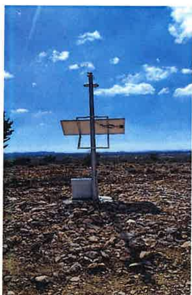
SLIKA 5: video nadzor na lokaciji saniranog deponija
