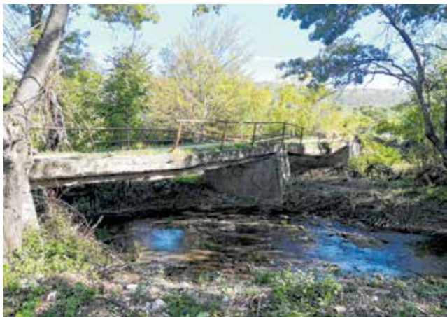
Most na Zrmanji čeka sanaciju
