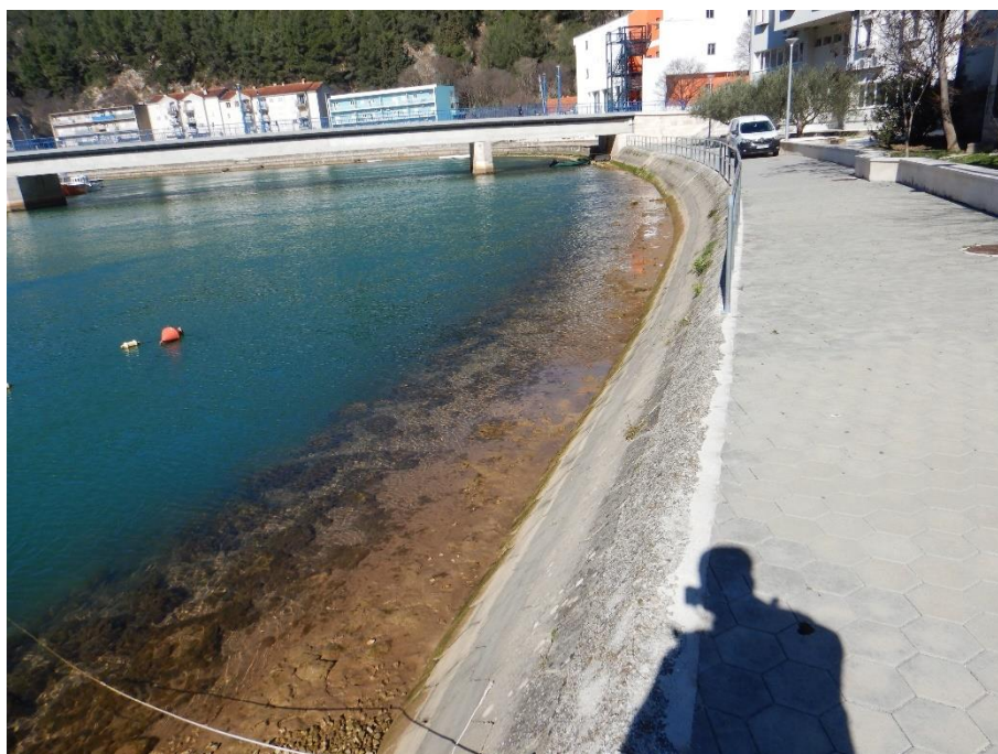
sl. 1.4.14: Pogled uzvodno na uređenu obaloutvrdu sa šetnicom uz koju se nalazi obrambeni zid nedostatne visine
